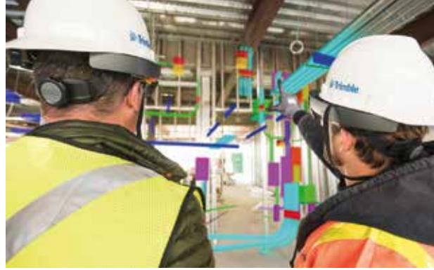
Mit der BIM-Methode sind ausführungsfähige Teilprozesse vom Büro über die Fertigung bis zur Bauausführung möglich.
